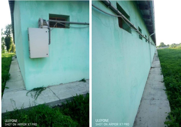
Рис. 2. Розміщення обладнання на приміщенні
